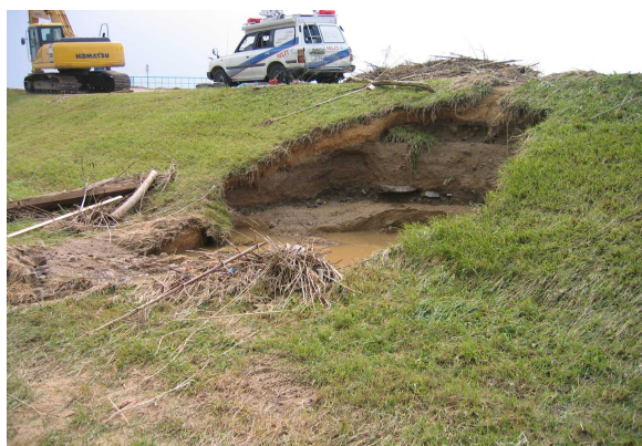
写真2 堤防部裏法面の洗掘状況 (神戸大学川谷教授提供資料)
