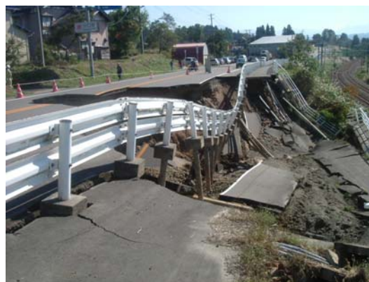
図1 新潟県中越地震における道路盛土被害例
