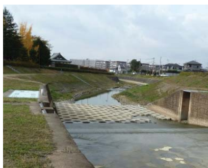
図5 堰倒伏時の堰下流 (H24. 12. 21)
