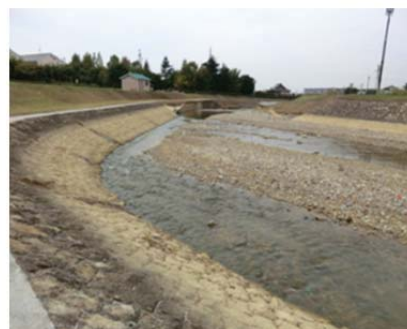
図6 堰倒伏時の堰上流 (H24. 12. 21)
